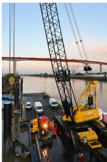
Le ponton Aloès, ici utilisé pour la rénovation des Ducs d'Albe du poste roulier de Cheviré.
